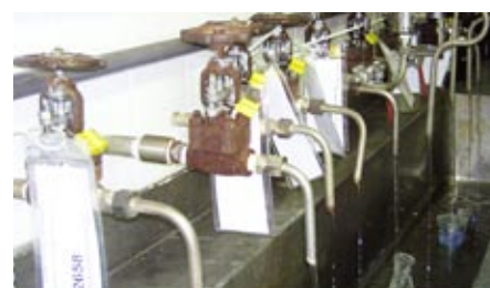
Engaxetamento de rotativos e válvulas na Suzano Papel & Celulose
