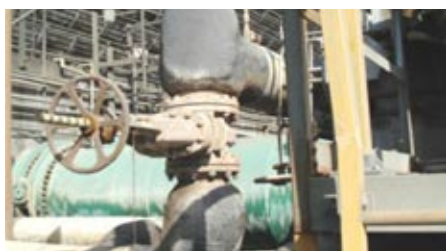
PQU: redução de perdas com engaxetamentos de Válvulas
