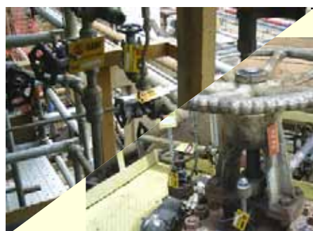
Válvulas engaxetadas e identificadas, na Replan
