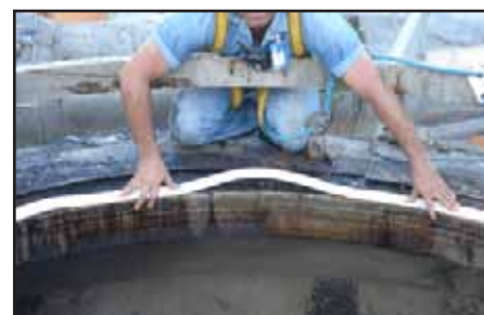
Junta de Tealon®TF1580 no digestor - Suzano
